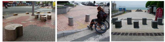
[그림 9] 블라드 설치 방법의 부적절한 사례
