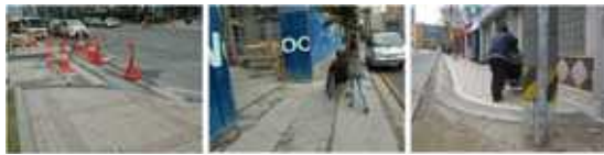
[그림 6] 공사로 인한 통행로 파손 현상
